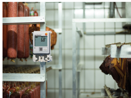
Kühlraum-Überwachung beim Metzger (testo Saveris 2-T2 mit externem NTC-Fühler mit Türkontakt)
